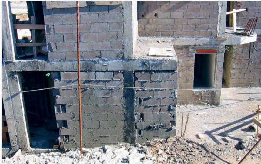
Es dürfte unschwer zu erraten sein, dass sich auch hier gravierende Schäden einstellen werden. Preisfrage: Wie viele unterschiedliche Putzuntergründe werden gezählt?
