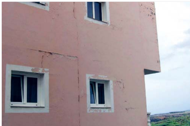
An der Fassade dieses Hauses sind die Fugen zwischen Pfeiler und Geschossdecke eindeutig durch Putzrisse markiert
