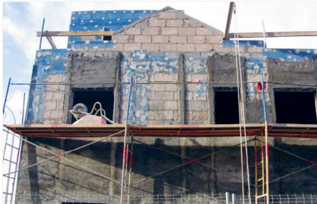
Der Versuch, mit Kunststoff-Gitterfolien die Problemzonen der Fassaden zu eliminieren. Auch das gelingt nicht, weil die Folien nicht in den Putz als Bewehrung eingebettet werden, sondern sich nur zwischen Mauerwerk und Putzunterseite befinden. Sie tragen lediglich dazu bei, dass die Haftfläche der Putzbeschichtung sich weiter verringert.
