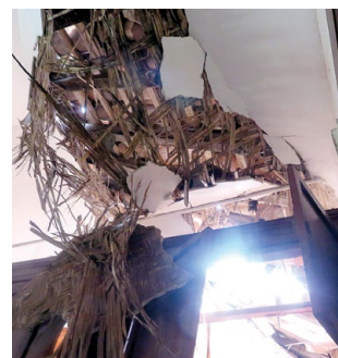
↑ Das Dach ist über einem Teil des Hauses mehr als baufällig.
