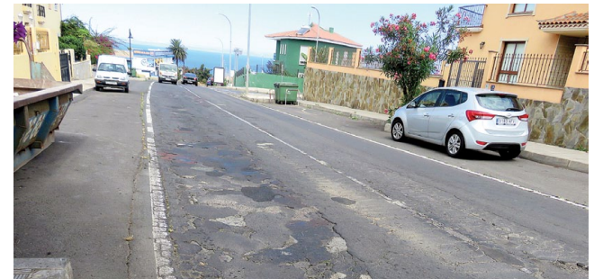
↑ Der Zustand der Straße in Richtung La Longuera und El Toscal ist fatal.
